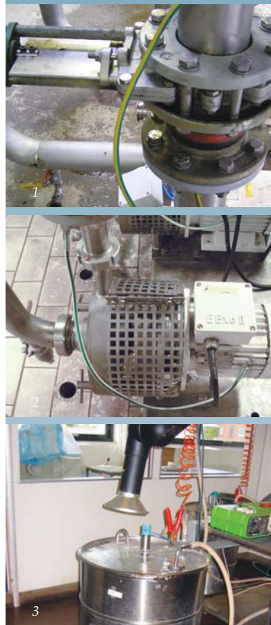
Billeder 1 og 2. Eksempler på faste potentialeudledninger ved rørsamling og pumper på de to første billeder og eksempel på flytbar manuel potentialeudledning (orange tænger) ved pumpning af væske på det sidste billede (3).
