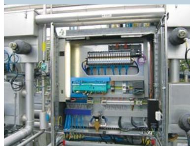
Eksempel på adskillelse af strøm-kredse i målerskab. Egensikrede strømkredse kan ikke antænde en eksplosion. I installationer med egensikrede strømkredse (blå ledninger på foto) skal klemmerne være pålideligt adskilt fra de ikke egensikrede strømkredse (hvide ledninger) f.eks. med en skillevæg eller som her med et gab på mindst 50 mm. Klemmerne for de egensikrede kredse skal være mærket som sådan.
