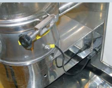
Potentialeudligning (sort ledning med stik) mellem anlægsdele på hvirveltørrer.
