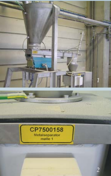
Billeder 1 og 2 viser metaldetektor som er opsat for at undgå gnister fra metal, som utilsigtet kan komme med i produktionsprocessen. Forud for metalseparatoren er der på hammermøllerne også opsat magneter, som også tilbageholder eventuelle metalstykker og dermed forebygger gnister fra disse.
